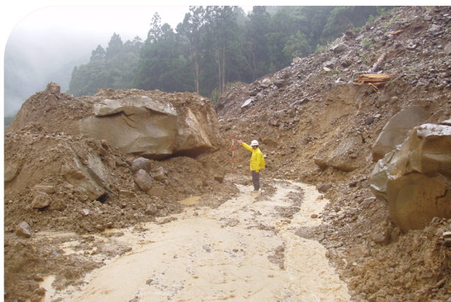
道路因災害豪雨受損，邊坡坍塌 (98 年莫拉克風災照片)
