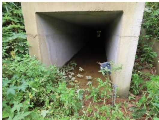
箱涵外部植被生長情形
