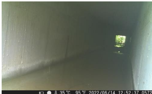
箱涵內部積水情形
