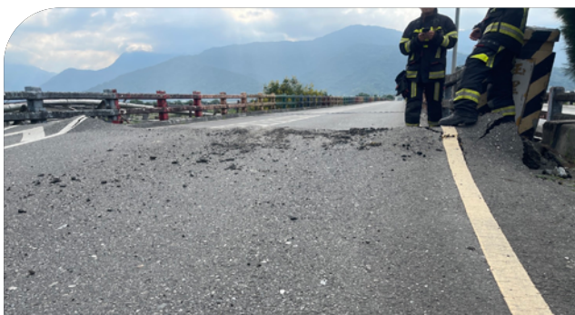
台9線玉里大橋(南下)A2伸縮縫擠壓路面隆起
