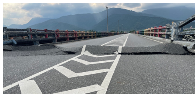
台9線玉里大橋(北上)橋面隆起
