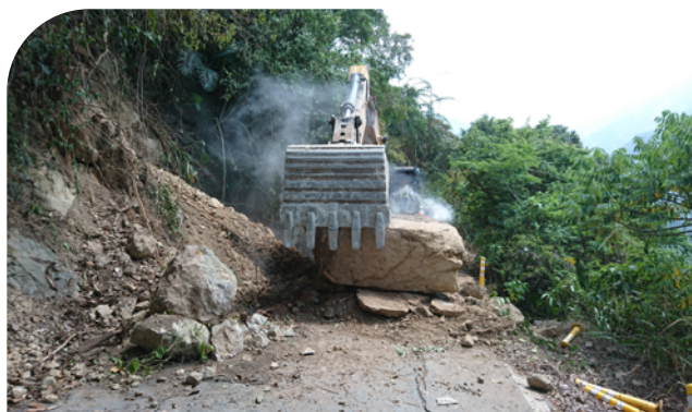
巨石橫躺阻斷交通，蘇改處調派怪手清理搶通
