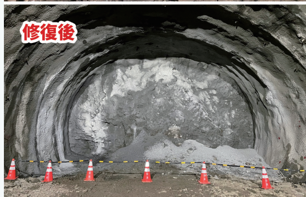
隧道抽坍及處置完成
