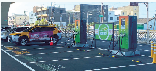
停車場設有電動車充電樁
