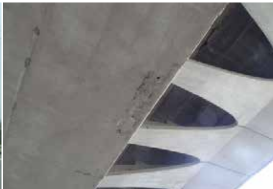
(2) 主梁混凝土劣化處 ( 掉落前 - 空洞 )
