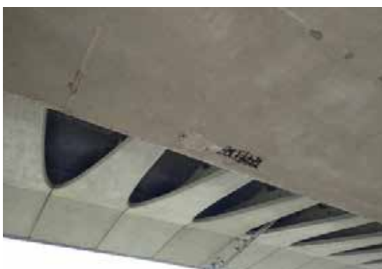
(3) 主梁混凝土劣化處 ( 掉落後 - 鋼筋外露 )
