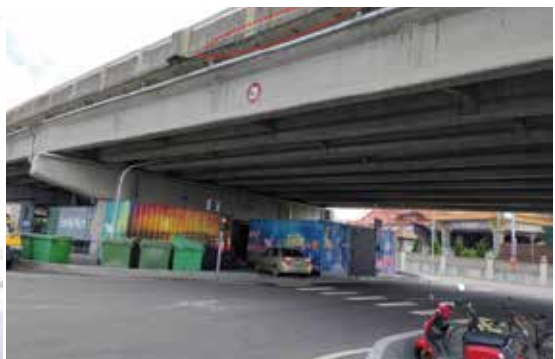
(2) 懸臂板混凝土劣化處下方為道路
