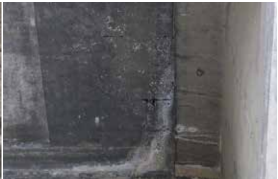
(4) 橋面板混凝土劣化處 (空洞)
