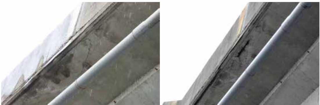
(3) 懸臂板混凝土劣化處 ( 掉落前 - 裂縫 ) (4) 懸臂板混凝土劣化處 ( 掉落後 - 鋼筋外露 )
