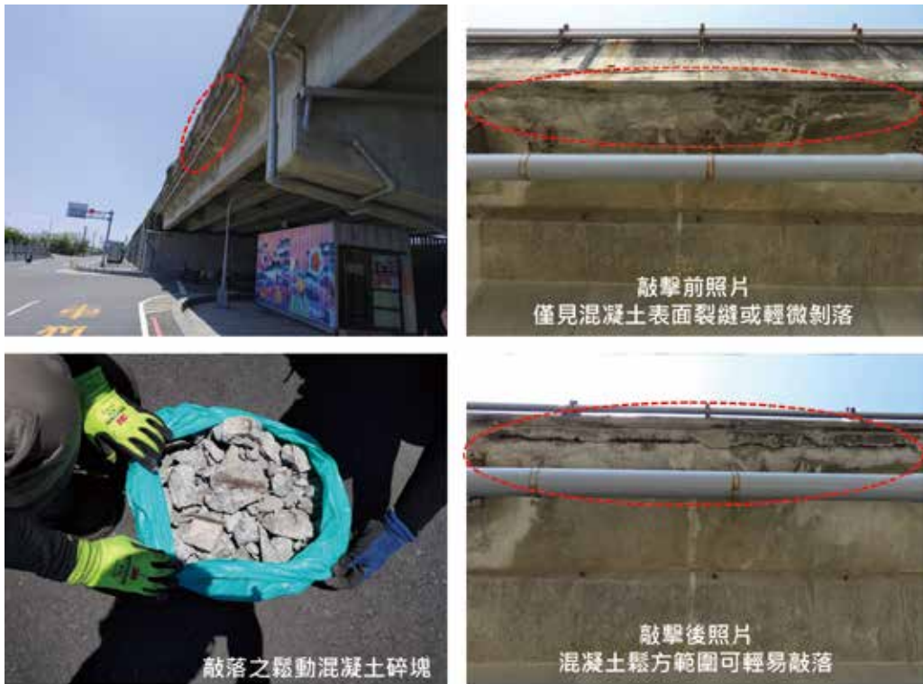
圖 4-8 混凝土劣化構件敲擊前後比對照片
