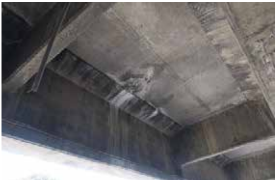
(3) 橋面板混凝土劣化處 (滲水白華)
