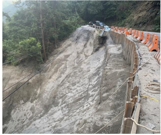
(11) 短期加固 76.2K 路基缺口之情形
