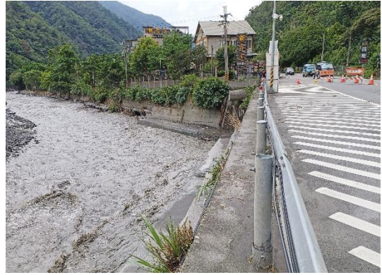
(2) 64.1K 總工研判曲流攻擊造成路基淘空下陷，經掃瞄確實淘空十分嚴重並以緊急回填補實
