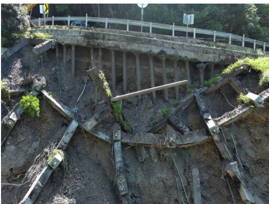
(5) 75.9K 因邊坡崩塌嚴重，安全係數已瀕臨界值，故總工指示迅速辦理邊坡減載及噴漿護坡等緊急作為
