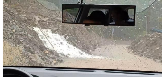
(2) 台14線兩旁土石堆高情形
