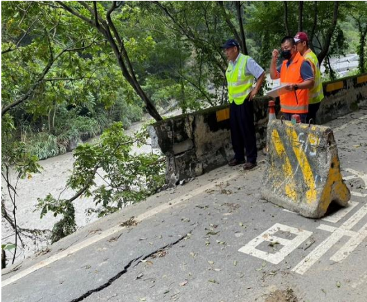
(3) 72.1K 路基缺口應係坡趾遭淘刷所致
