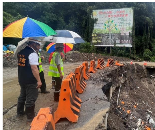
(6) 雨勢來襲，撐傘繼續勘查，盼能儘早完成路基加固護民安行
