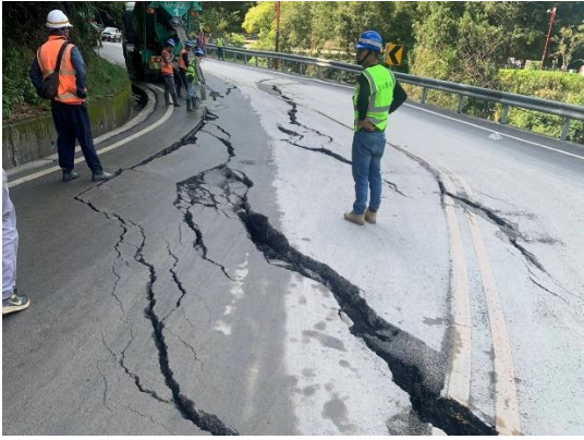
(1) 台 14 線 75.9K 路基嚴重開裂致通行風險高而管制封閉
