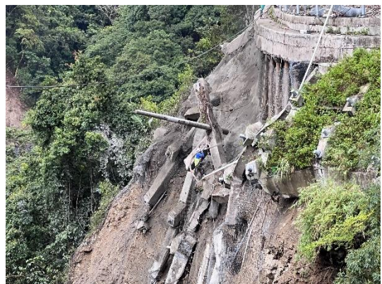
(6) 將尚有支撐之基樁以噴漿固結，再辦理坡面減載，提升安全性；長期則需強化坡腳遭蝕溝淘刷。
