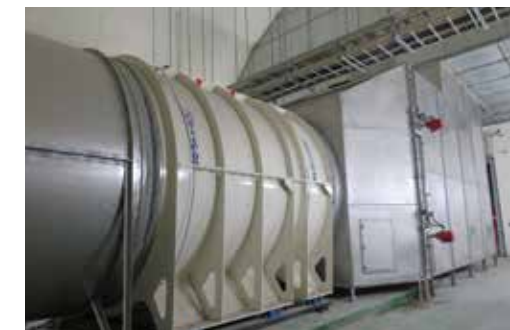
● 仁水隧道排煙軸流式風機
