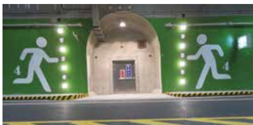
● 隧道逃生門標示燈
