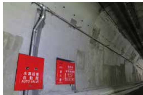
● 仁水隧道消防栓箱及水霧自動閥箱
