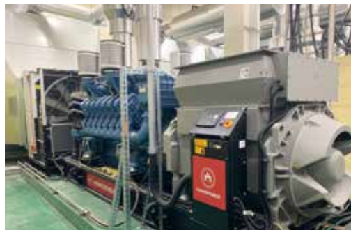
● 特高壓機房發電機測試
