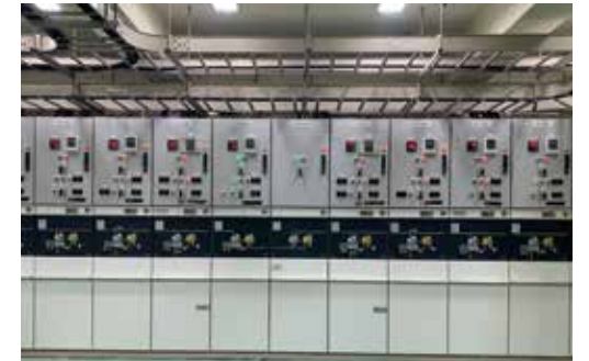
● 特高壓機房保護電驛
