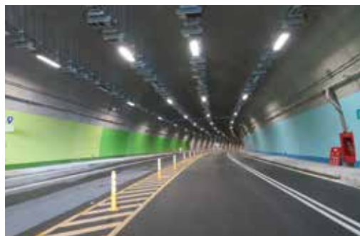
● 隧道照明燈具
