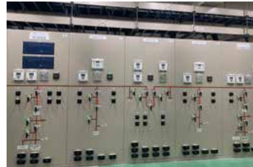
● 漢本特高壓變電站
