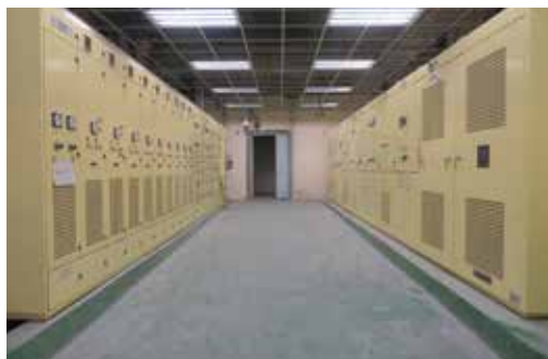
● 輔助機房高低壓配電盤
